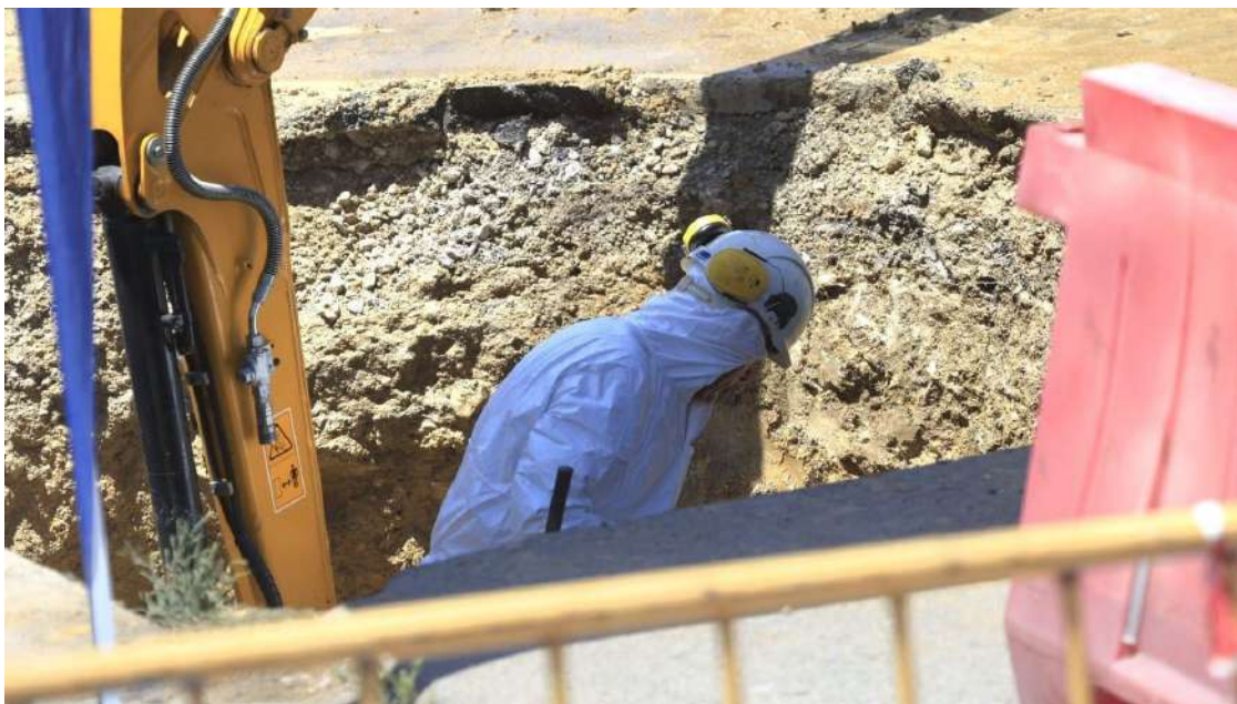
Otro corte de agua en Algeciras por una avería en las obras del Acceso Sur. Un operario trabaja en la avería.
